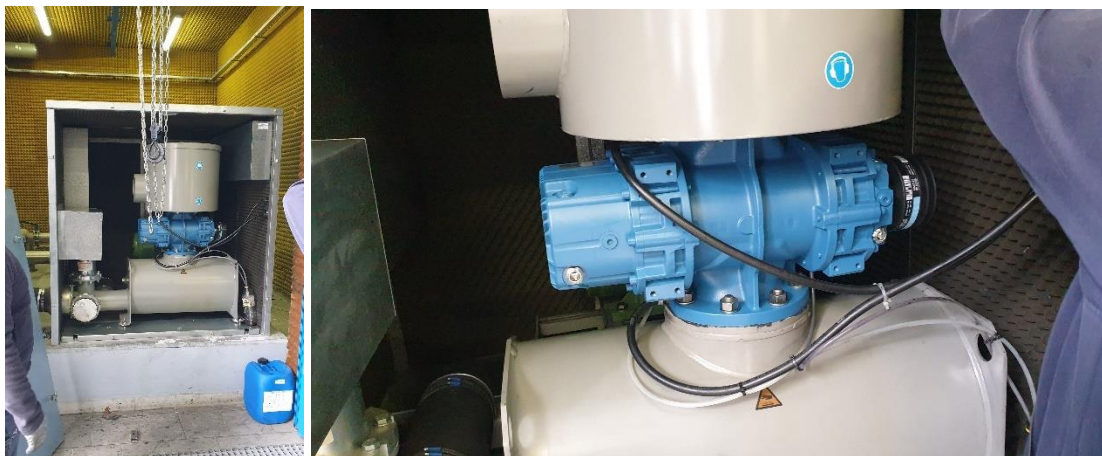
Slike: vgrajeno novo puhalo na CČN Ilirska Bistrica
