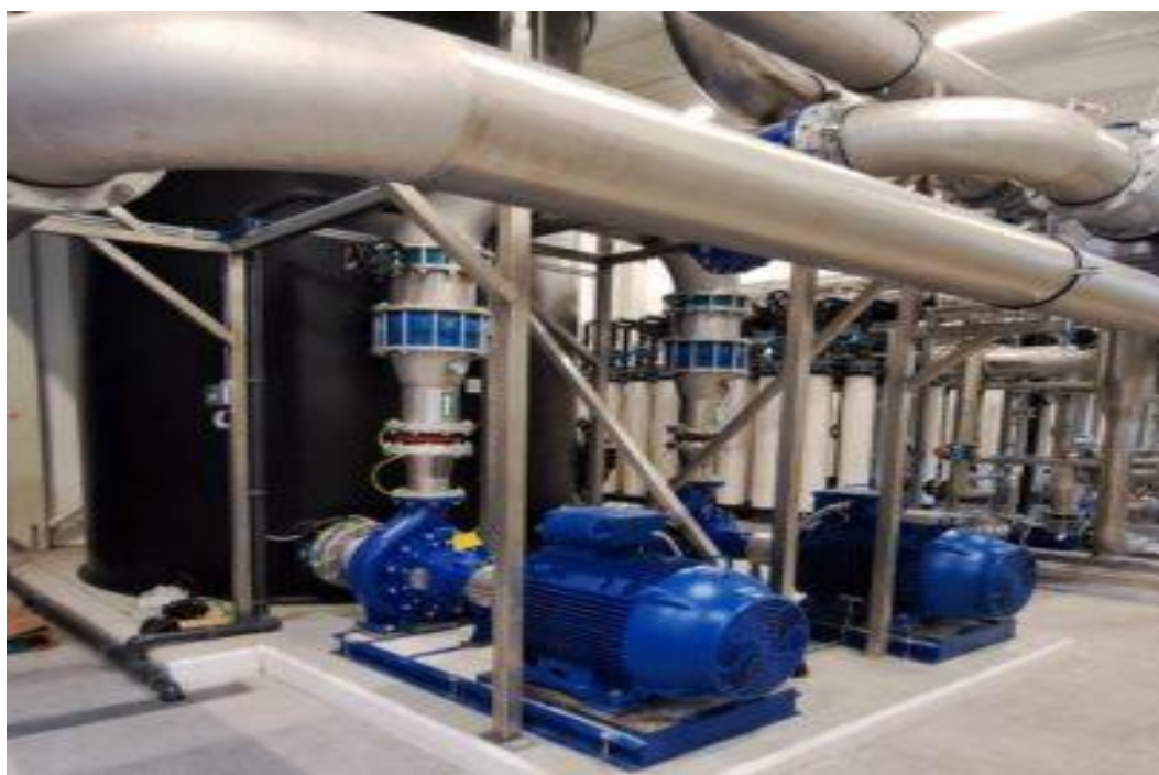
Slika2: Ultrafiltracija v Vodarni Ilirska Bistrica
