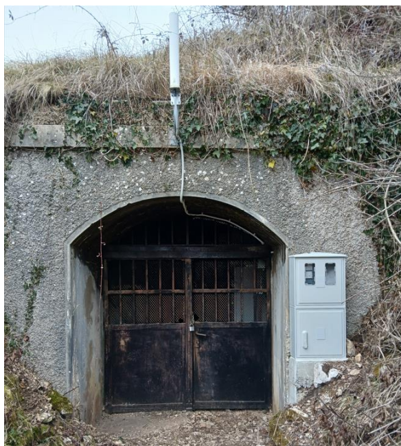
Slika: Nova elektro PMO omarica pred vhodom v tunel.
